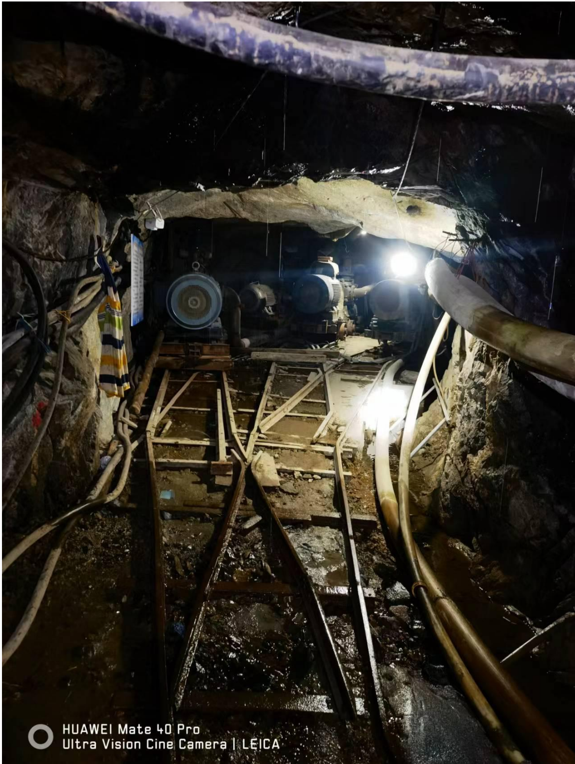
矿山-126m 中段水泵房
