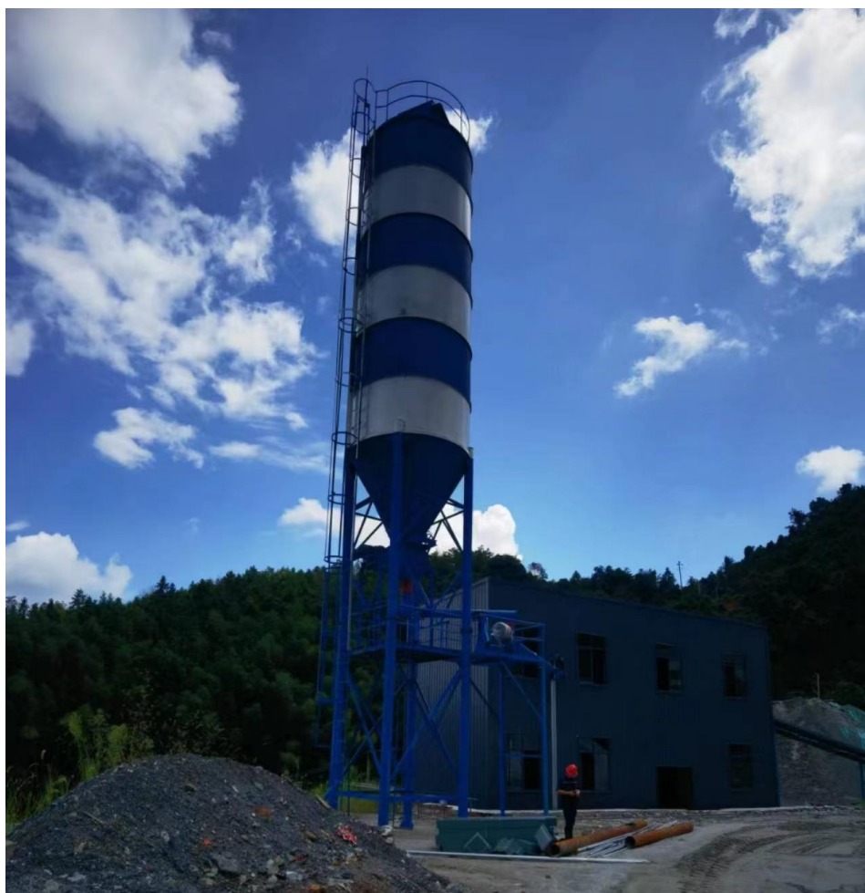
图 7 矿山新建充填站
