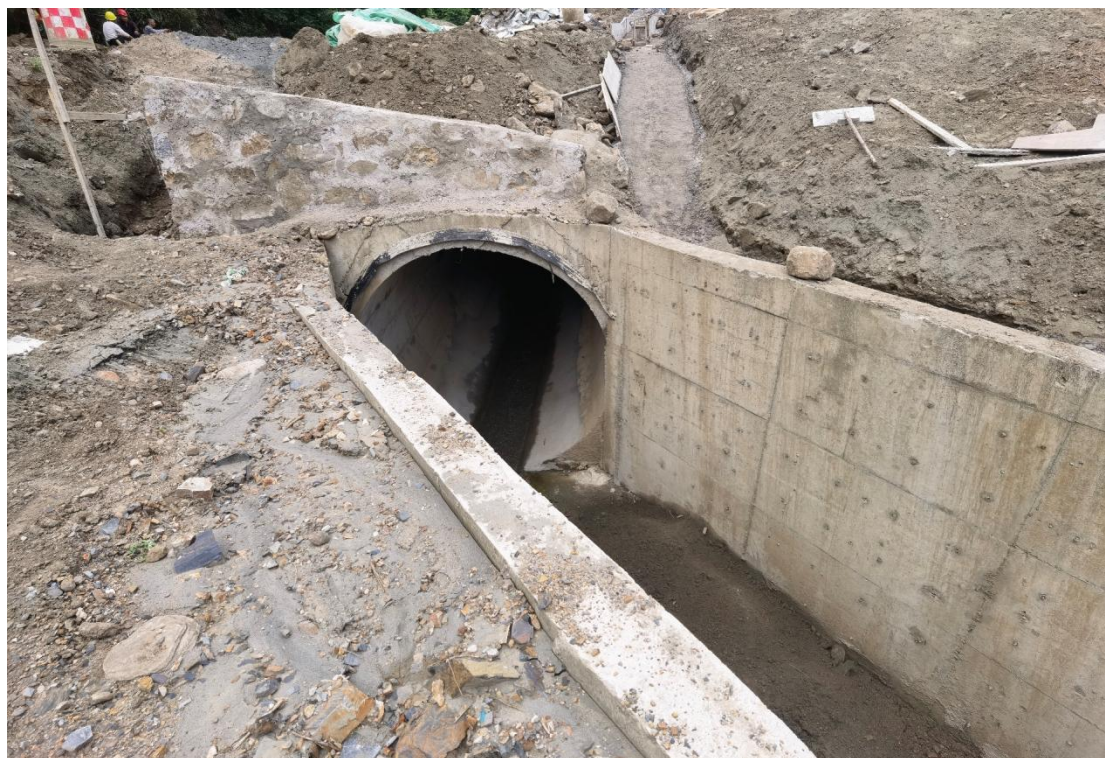
图 2.10-11 库底排水暗涵出口
